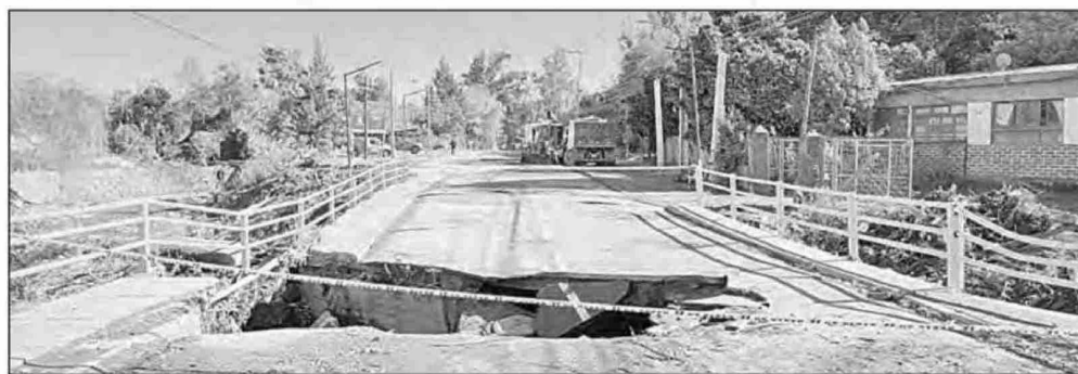
Tras el desborde del estero Los Loros el puente Merino quedó inutilizable, por lo que se gestionó un puente mecano.
