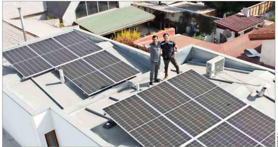
La startup se dedica a la instalación de paneles solares para casas. Para ello, construyeron una plataforma online y como parte de su propuesta ofrecen opciones de financiamiento.
