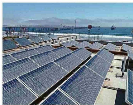
132 PANELES SOLARES INSTALADOS EN EL CENTRO DE VISITAS PERMITEN CUBRIR HASTA UN 40% DE LA ELECTRICIDAD QUE DEMANDA ESTE EDIFICIO.
