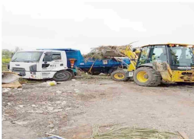
La ribera del río Lontué, a la altura de El Maitén, fue escenario de un gran operativo municipal de limpieza.
