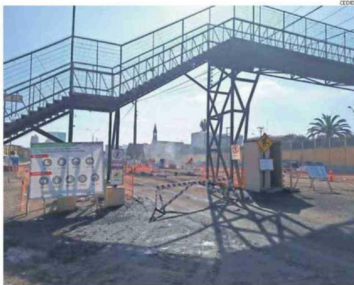
EN LA CARACTERÍSTICA PASARELA PEATONAL DEL SECTOR "PATIO BELLAVISTA SE IMPLEMENTARÁ UNA BARRERA.
