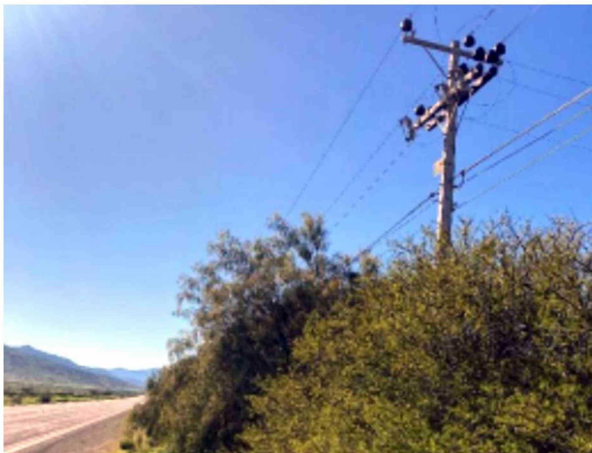
SEC constató la presencia de vegetación bajo las líneas de media y baja tensión en distintos tramos de la ruta D-595 y en predios particulares de Río Hurtado.
