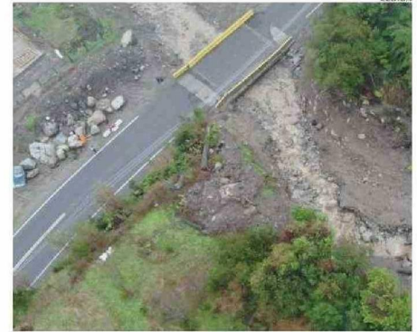
LA ZONA DE LA REMOCIÓN SE MANTIENE EN CONSTANTE SUPERVISIÓN.
