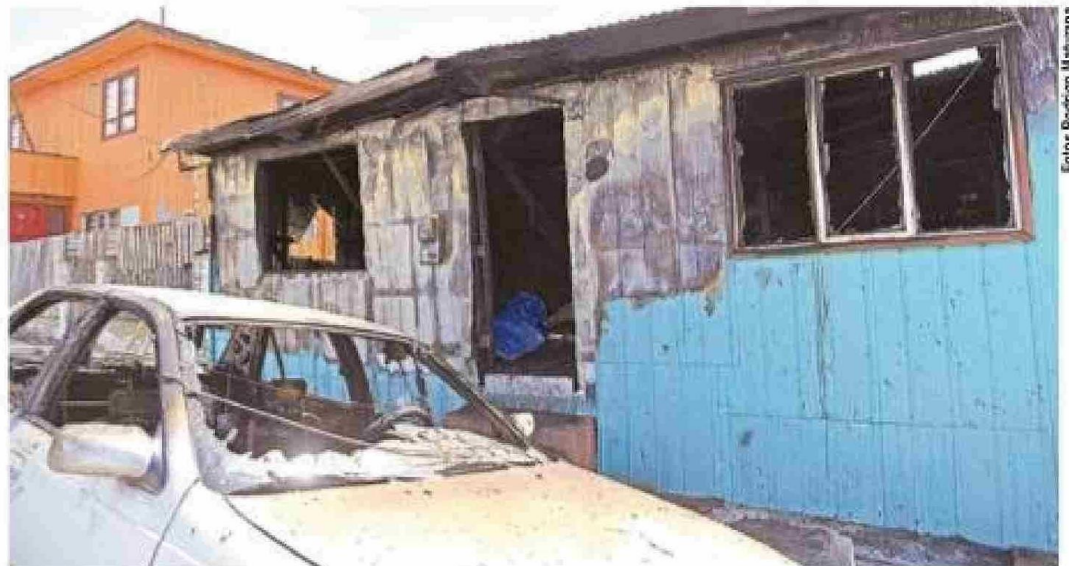
Totalmente consumida resultó esta vivienda y el vehículo también resultó con daños. Labocar se constituyó en el lugar para realizar las pericias del incendio.
