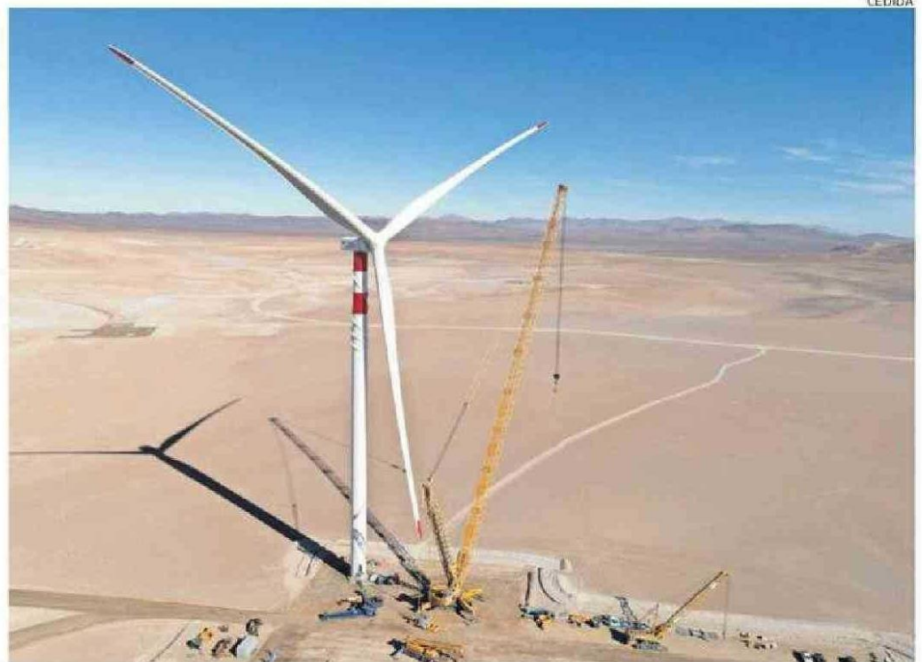
EL PROYECTO EÓLICO DE ENGIE EMPLAZADO EN LA COMUNA DE TALTAL, CONSIDERA 57 AEROGENERADORES.
