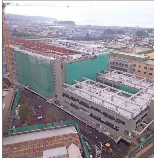
A marzo pasado, las obras del Hospital Las Higueras de Talcahuano llevaban un avance del 68%.
