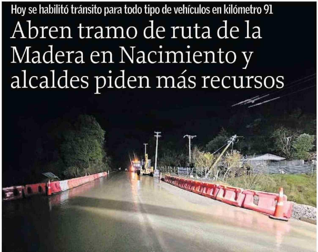
Con señaléticas y demarcaciones, el Ministerio de Obras Públicas habilitó el tránsito a todo vehículo en el kilómetro 91.
