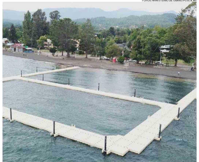
LA INICIATIVA CONSISTE EN LA RENOVACIÓN DEL MUELLE FLOTANTE EXISTENTE EN EL LAGO CALAFQUÉN.
