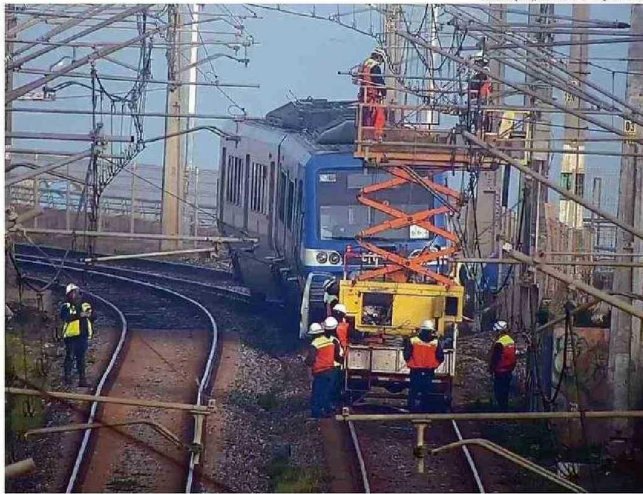
TRAMO DEBIÓ SER DESENERGIZADO POR PERSONAL ESPECIALIZADO A ESO DE LAS 7 DE LA MAÑANA.
