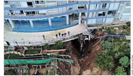
FAENAS.— Ayer el Serviu dispuso cubrir la superficie del socavón con polietileno para evitar que se sigan erosionando sus bordes, y limpiar sumideros.
