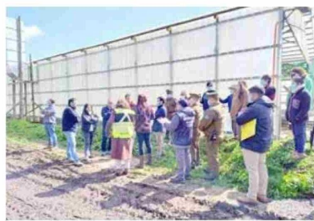
En el predio de la Guanera San Francisco también se verificó la existencia de edificaciones que superan altamente los metros construidos informados a la Dirección de Obras.
