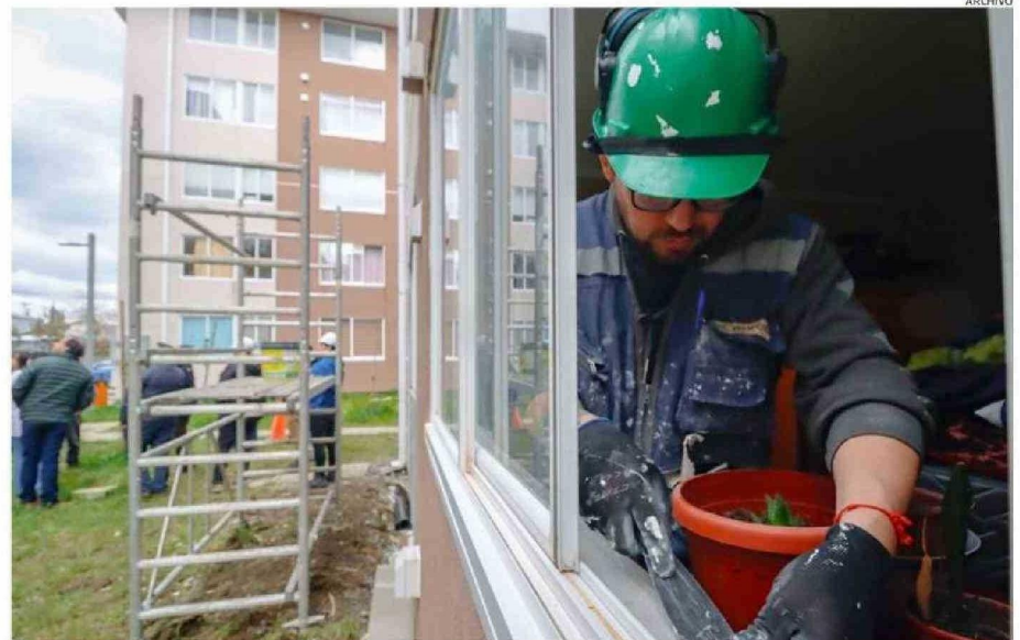
EN SEPTIEMBRE PASADO, LA CONSTRUCTORA INGEVEC REALIZÓ TRABAJOS PARA REPARAR DAÑOS POR HUMEDAD Y POR LA APARICIÓN DE HONGOS.
