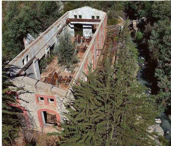
LA FALTA DE CUIDADOS DEL RECINTO LO HA DETERIORADO AÚN MÁS, ADEMÁS DE SER AFECTADO POR ROBOS.
