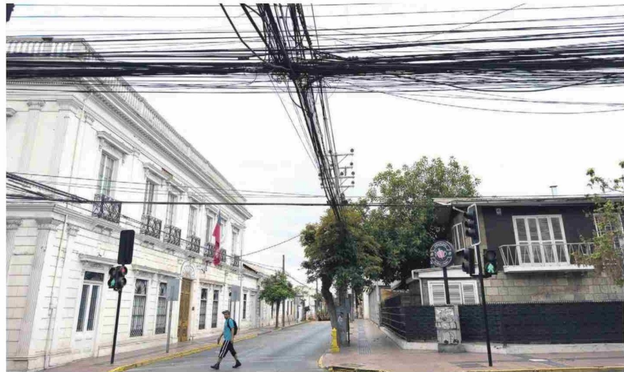
La seremi de Transportes y Telecomunicaciones aclaró que es responsabilidad de las empresas el retiro de cables, pero están a la espera del visto bueno del reglamento.
