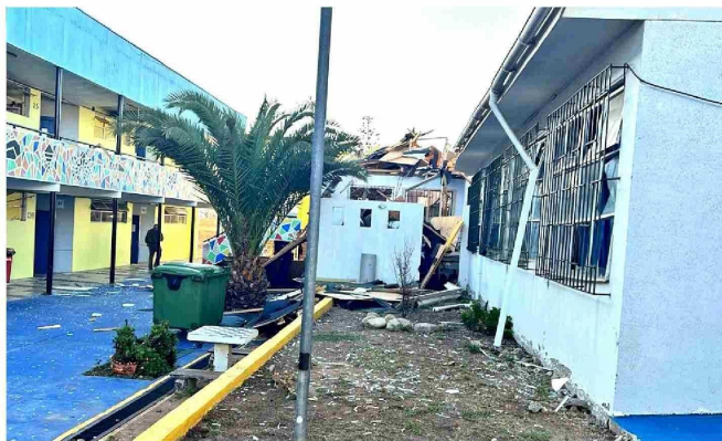
EL LICEO EL Liceo Nicolás Federico Lohse Vargas quedó con serios daños en su infraestructura tras la explosión de gas.
