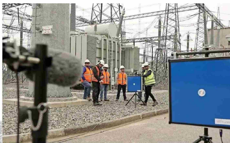
Una de los proyectos más exitosos surgidos de Transelec Ventures es el piloto de cancelación de ruido usando paneles en la subestación Ancoa, en la Región del Maule.
