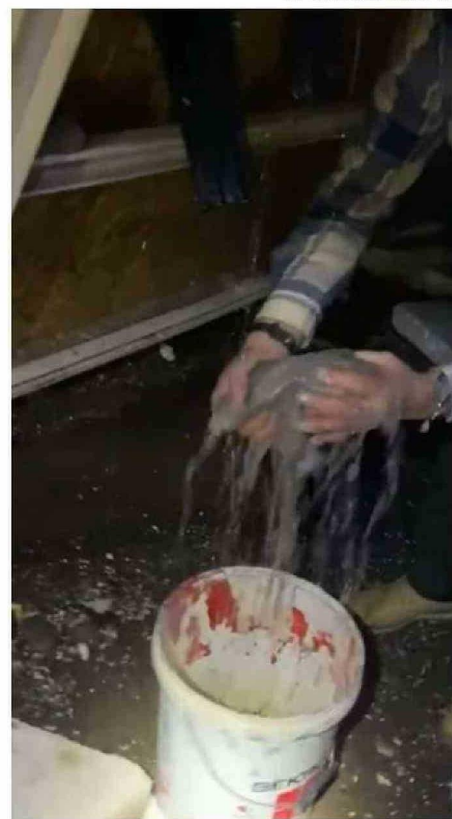
LA IMAGEN ES UNA CAPTURA DE VIDEO DEL ASISTENTE DE LA EDUCACIÓN MAX LEIVA, CUYO TRABAJO DIARIO ES SACAR EL AGUA DEL ENTRETECHO.
