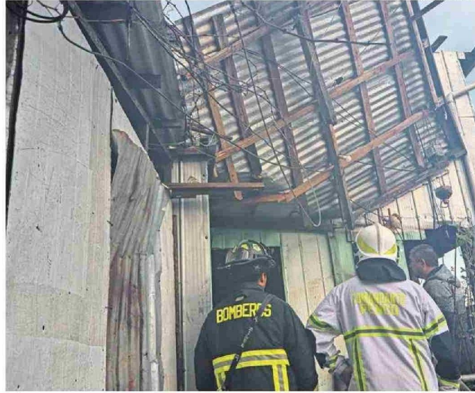
PRODUCTO DE LOS TORNADOS SE VOLARON TECHUMBRES, LO QUE PROVOCÓ ANEGAMIENTOS.
