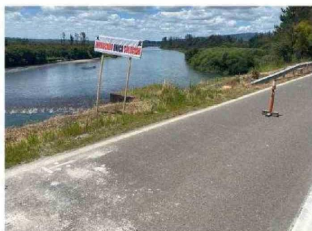
ESTE SOCAVÓN HA IDO CRECIENDO DESDE EL AÑO 2016 A LA FECHA PRODUCTO DE LA FUERZA DEL AGUA.
