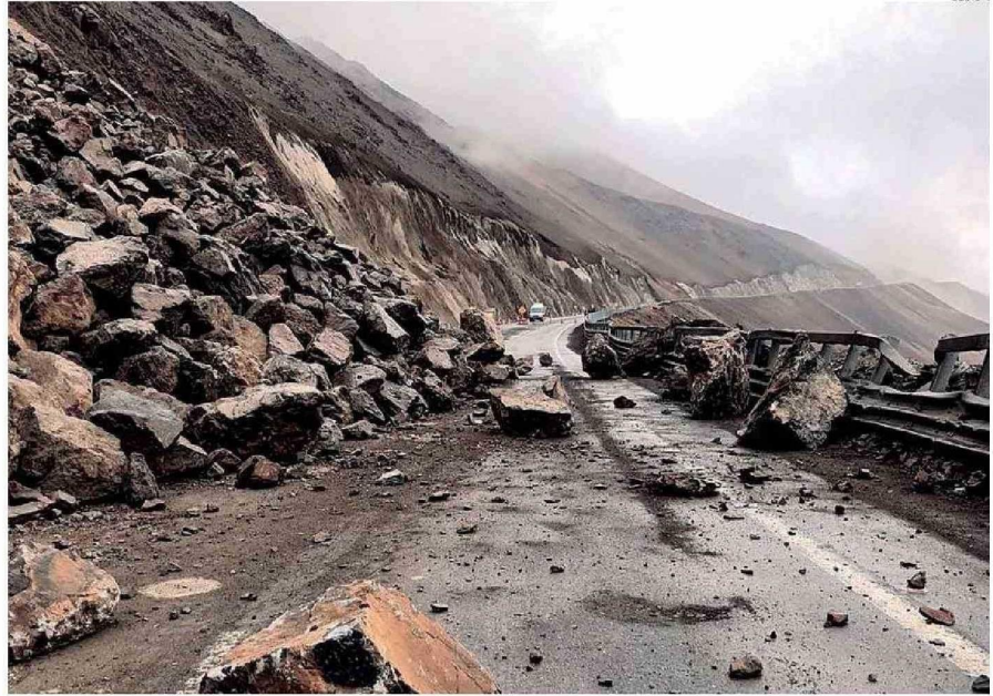
LAS OBRAS DE REPARACIÓN DE LAS AFECTACIONES A LA RUTA 5 NORTE PODRÍAN EXTENDERSE POR 12 MESES.
