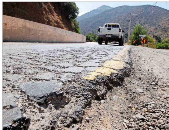
Problemas En la ruta hay problemas de pavimentación, daño en las barreras de contención, además de rodados de piedra, sobre todo tras las intensas lluvias y nevadas del 2024.
