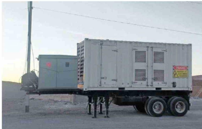
AYER POR LA MAÑANA SE LOGRÓ INSTALAR EL GENERADOR ELÉCTRICO A LA ESPERA DE LA REPOSICIÓN TOTAL.
