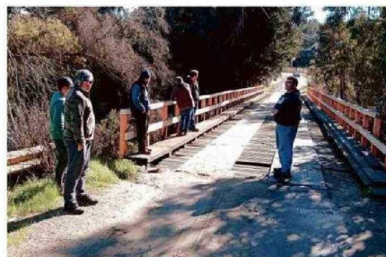
EN 2012 SE ANUNCIÓ LA REPARACIÓN DEL PUENTE, AÚN NO SE EJECUTA.
