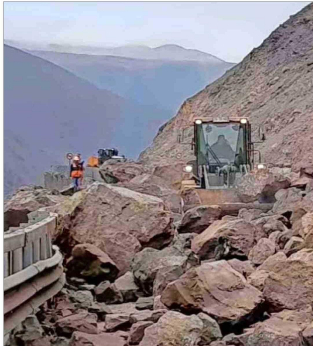
MAQUINARIA. — Vialidad estimó un plazo de un año para la reparación. El pueblo de Cuya ha colapsado por miles de personas y vehículos varados.
