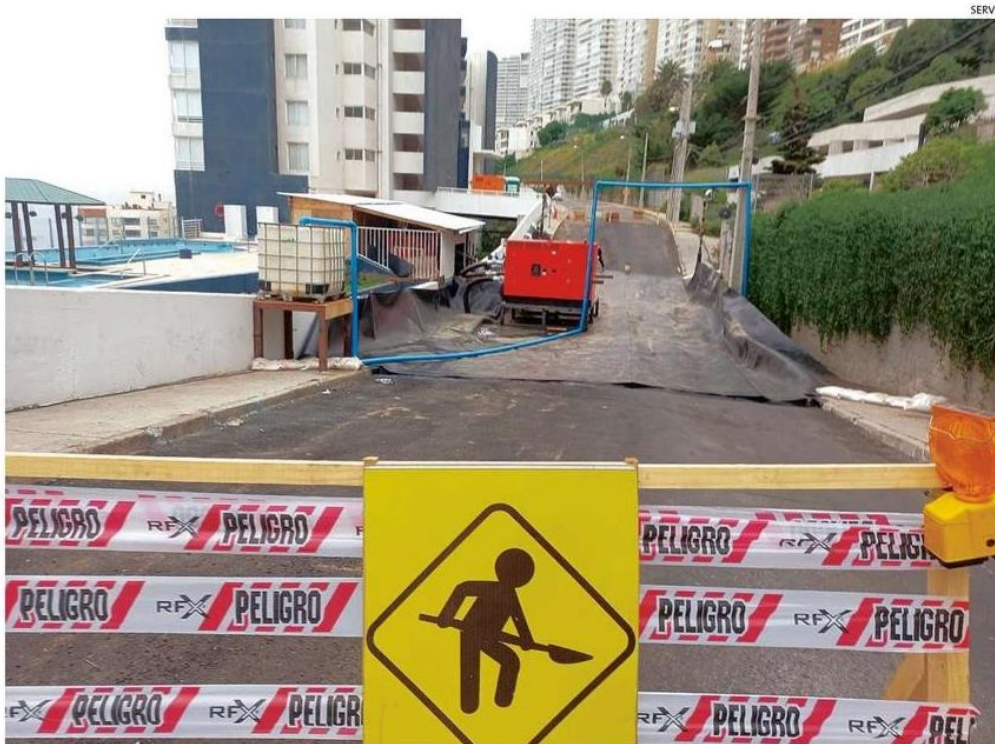
CALLE LAS PERLAS PERMANECERÁ CERRADA, AL MENOS, HASTA EL DOMINGO. EQUIPOS DE SERVIU ESTARÁN MONITOREANDO EN TERRENO.
