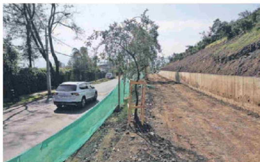
► En la calle Paul Harris se puede apreciar la falla.
