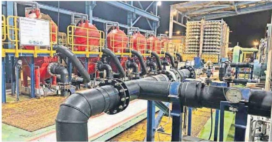
LA DESALADORA DE ADASA PRODUCE CASI 1.000 L/S. LA PLANTA DE ESCONDIRA/BHP PODRÍA APOYAR CON UN SUMINISTRO ALTERNATIVO A LA CIUDAD.
