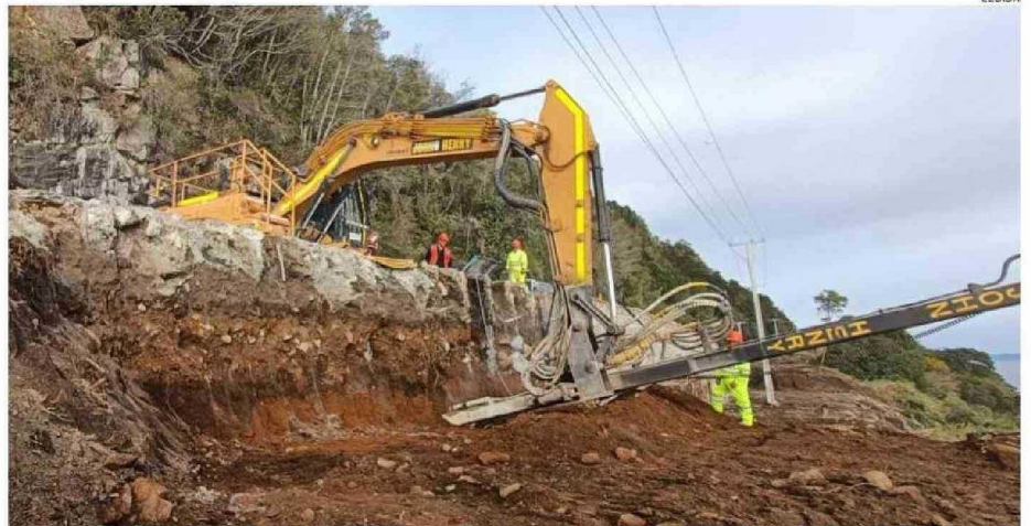
SE CONSTRUYE UN MURO CORTINA DE HORMIGÓN DE SHOTCRETE CON MICROPILOTES, MÁS DOS NIVELES CON PERNOS DE ANCLAJE POSTENSADOS.
