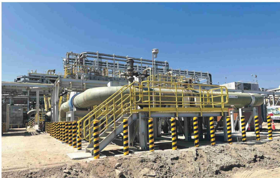
Según el estudio, gran parte de la población estaría a favor de una planta desaladora versus otros métodos para obtener agua potable. CEDIDA
