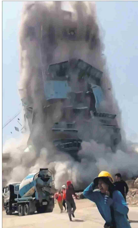
Segundos después, la estructura se desintegra por completo.
