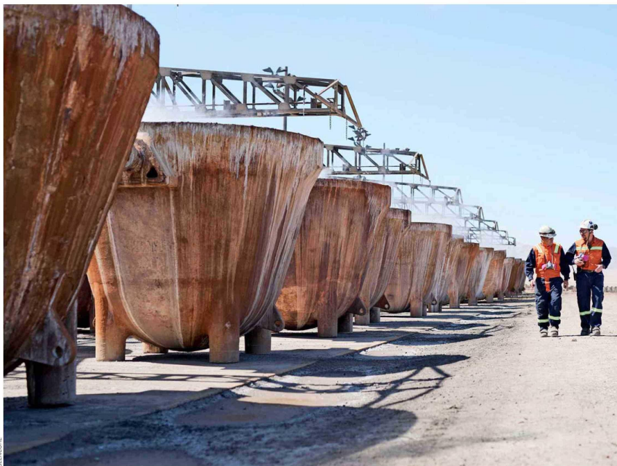
El Complejo Metalúrgico Altonorte puso en marcha un innovador sistema de enfriamiento de escoria en ollas, enmarcado en los lineamientos de eficiencia hídrica.
