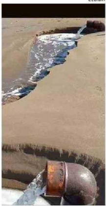
DESCARGA DE AGUA DE MAR.
