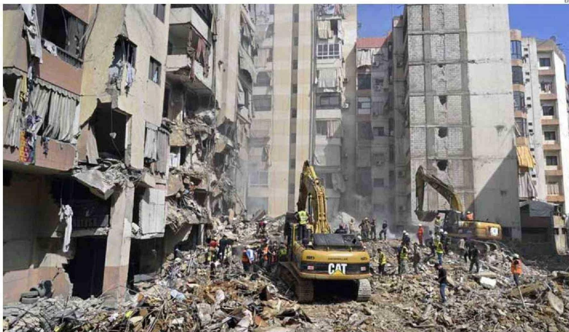
CON EXCAVADORAS LIMPIABAN AYER LOS ESCOMBROS EN EL LUGAR QUE FUE BLANCO DEL ATAQUE ISRAELÍ EL VIERNES, EN EL SUBURBIO AL SUR DE BEIRUT.
