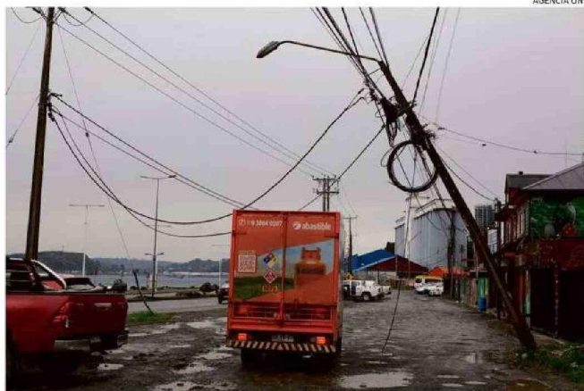
UN POSTE QUEDÓ A PUNTO DE CAER DEBIDO AL FUERTE VIENTO QUE SE HIZO SENTIR EN TODA LA CIUDAD.
