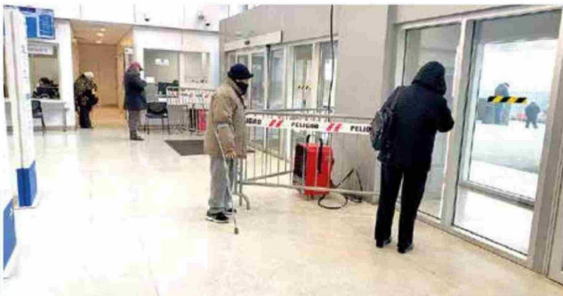
CURICÓ. En plena ola de frío, el nuevo Hospital de Curicó, inaugurado hace pocos meses, sigue con problemas en su sistema de climatización, teniendo que acudir a calefactores para temperar distintas áreas del recinto,
