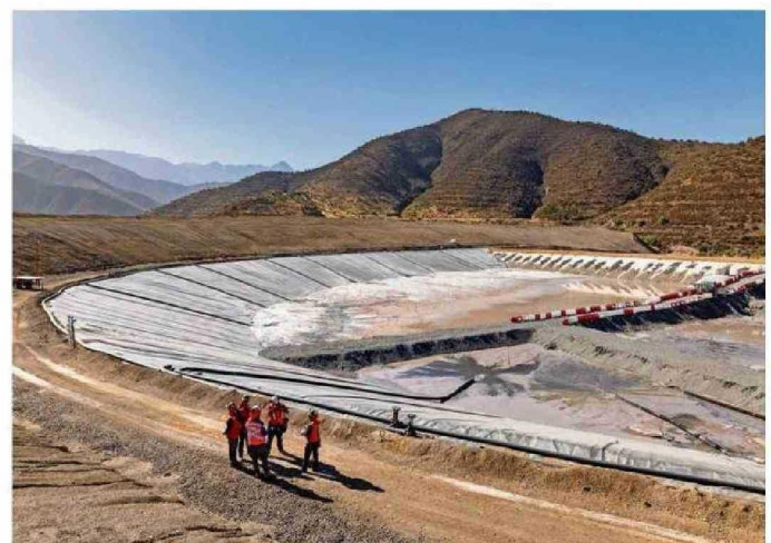
HDS HA PERMITIDO UNA RECUPERACIÓN DE AGUA CERCANA AL 80%.
