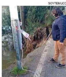
PREOCLUPAN LOS SOCAVONES EN LA ZONA COSTERA.
