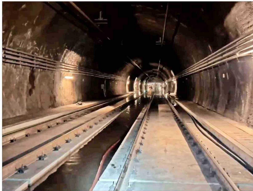
CIERRE. — Durante cuatro días se prolongaron los problemas en estaciones que estuvieron cerradas. La más afectada fue la estación Bío Bío, en San Miguel.
