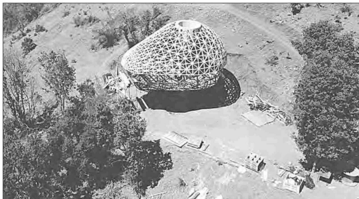
Así está quedando la Palta House que se construye en el sector de San Isidro.
