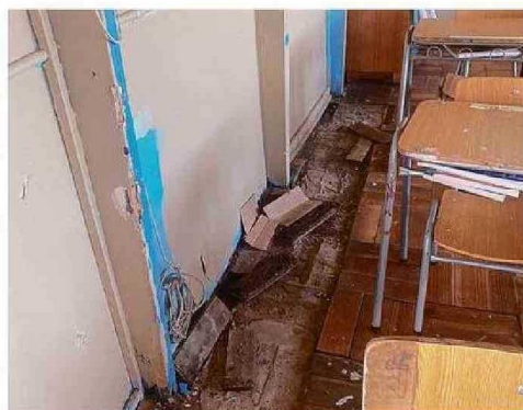
DESPRENDIMIENTO AFECTÓ A LA ESCUELA CIUDAD DE BERLÍN.
