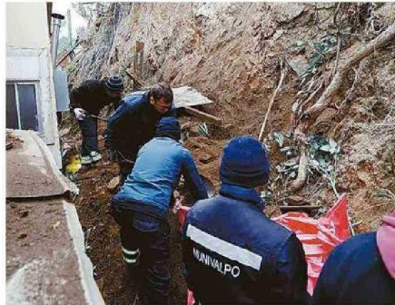
TECHUMBRES, MUROS Y PAREDES SUFRIERON CON LAS LLUVIAS.
