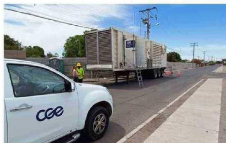
LOS EQUIPOS DE RESPALDO DE LA COMPAÑÍA INSTALADOS EN PICA.
