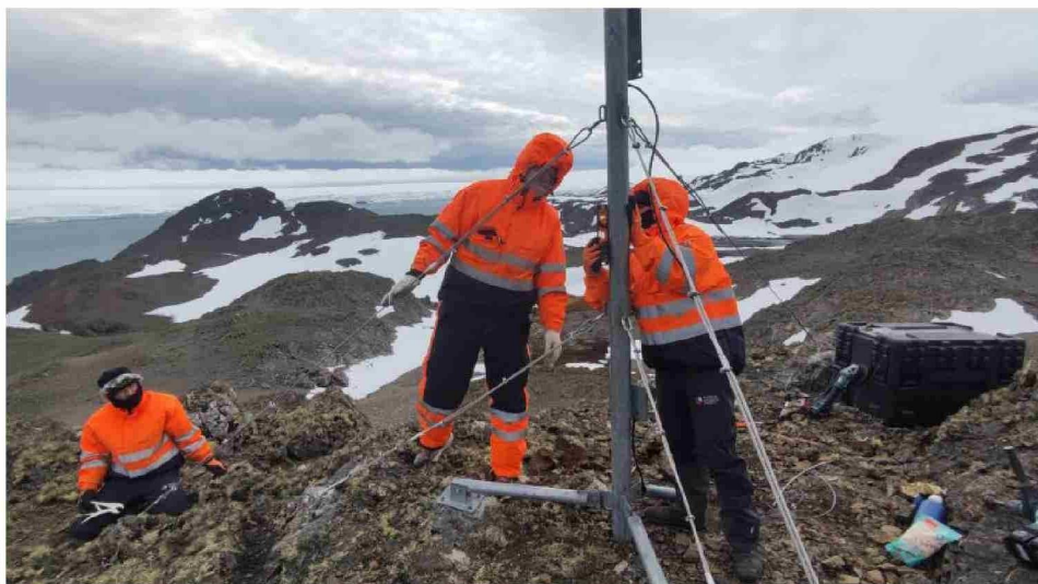
El Inach entregó detalles de los sensores instalados en la Antártica.
