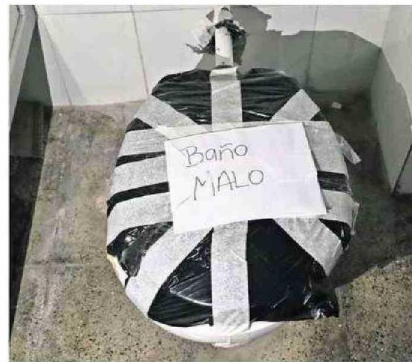
CONDICIONES DEL BAÑO DEL SERVICIO DE UHCIP DEL HOSPITAL.
