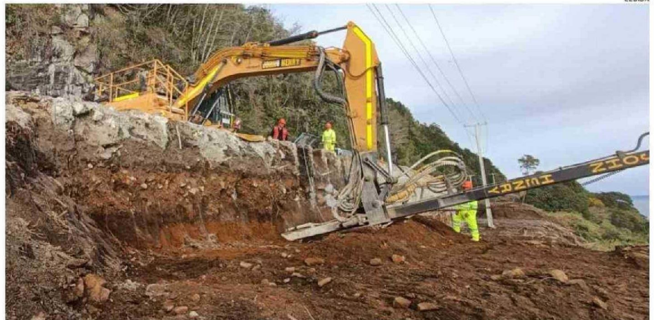
SE CONSTRUYE UN MURO CORTINA DE HORMIGÓN DE SHOTCRETE CON MICROPILOTES, MÁS DOS NIVELES CON PERNOS DE ANCLAJE POSTENSADOS.
