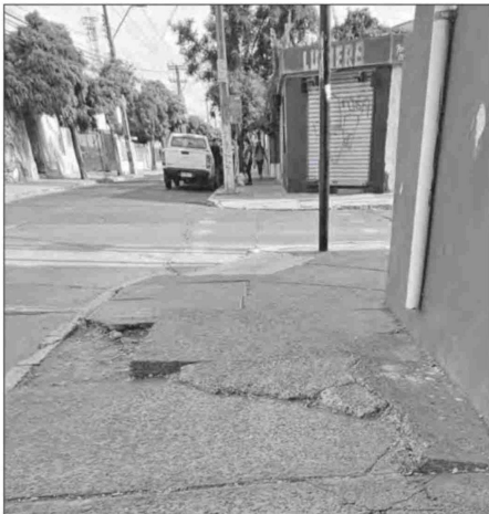
En la esquina de Blanco con La Concepción queda en evidencia el problema de las veredas.
